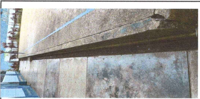
Foto 5: se observa cuneta sin parrilla de seguridad.
