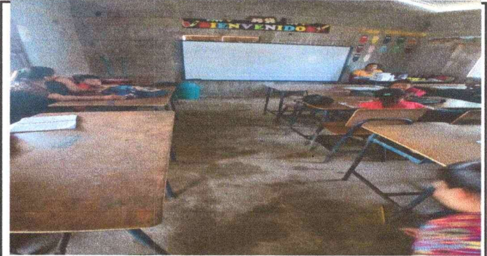
Foto 2: El aula se observa el deterioro de piso
